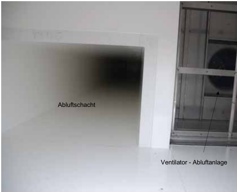
Lüftungsschacht mit Abluftanlage
